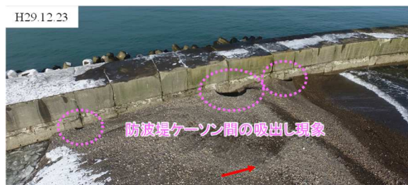
写真 3.2 防波堤ケーソン間の吸出し現象（閉塞②）
