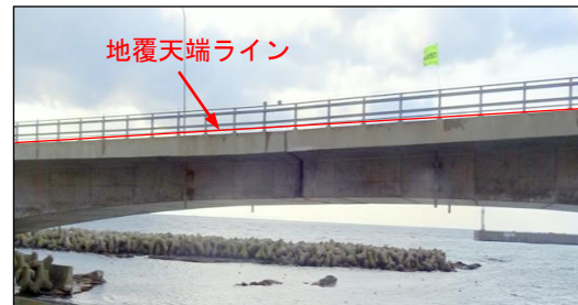
図2 支間中央部の垂れ下がり状況
