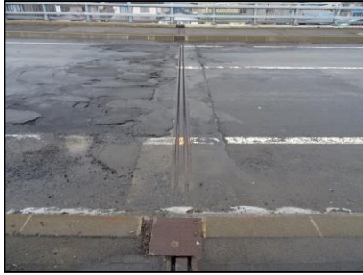
図 5 舗装損傷と滞水状況
