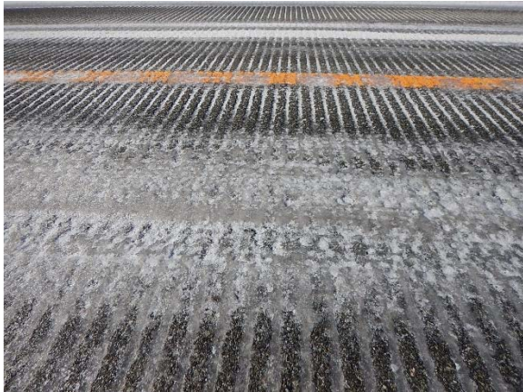
写真-2 グルーピングの目詰まり
