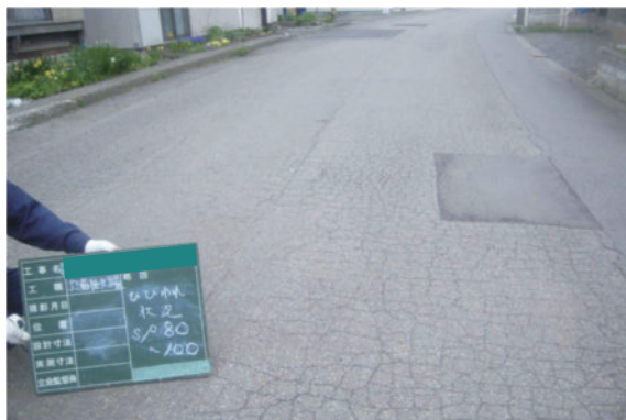
写真 2.2 現地ひび割れ状況
