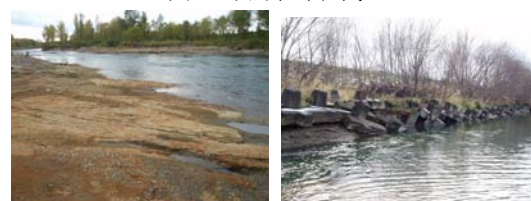
写真-1 露岩状況：河口から160.2km付近(左) 洗掘による護岸の浮き上がり(右)
