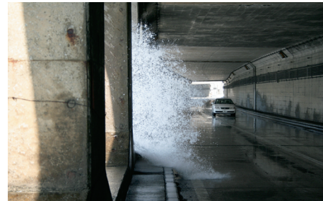
写真-1.2 越波状況①
