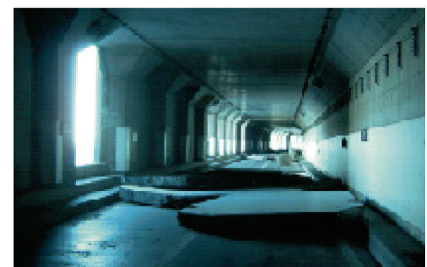
写真-1.4 越波防止板倒壊状況
