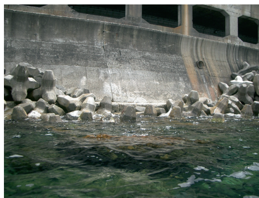
写真-3.2 覆道部消波ブロック消失状況
