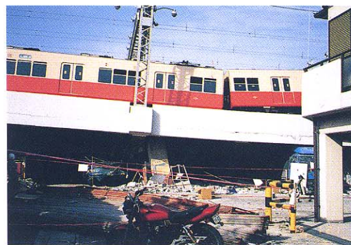
写真-3 鉄道高架橋の崩壊
