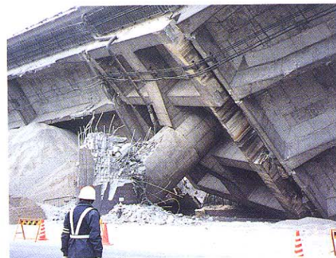
写真-1 ピルツ橋の崩壊
