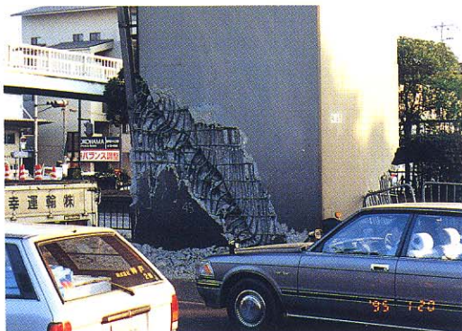
写真-4 単柱の塑性ヒンジ
