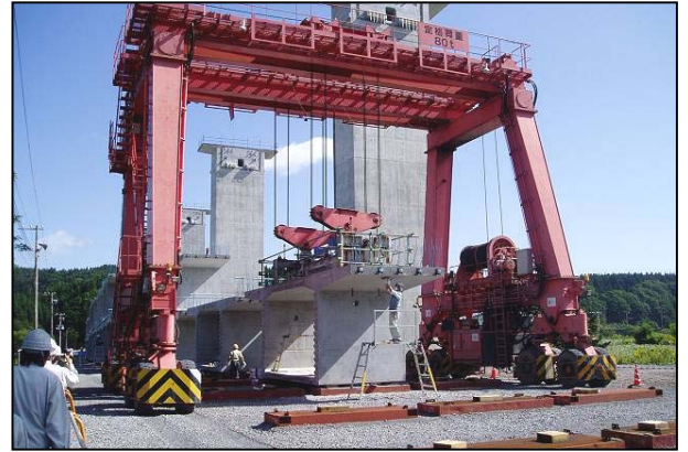
写真4 セグメントストックヤード
